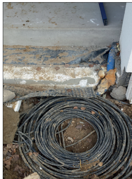
Fot. 5. W górnej części zdjęcia krawędź betonowej płyty garażu z uskokiem ok. 0,3 m do terenu. Porzucony niechlujnie czynny kabel zasilający budynek oddany do użytku
