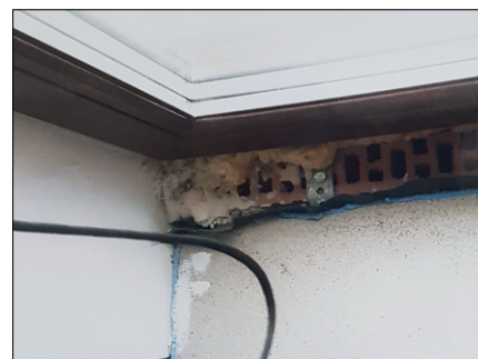
Fot. 3. Niewykończone okno od wewnątrz, pas źle ułożonej cegły dziurawki
