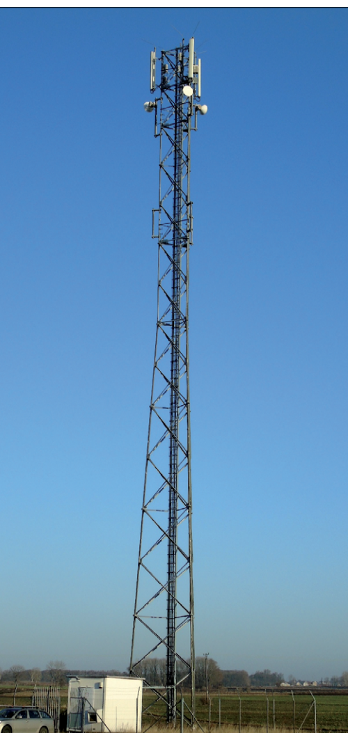
Fot. 1. Przykładowa stacja bazowa
