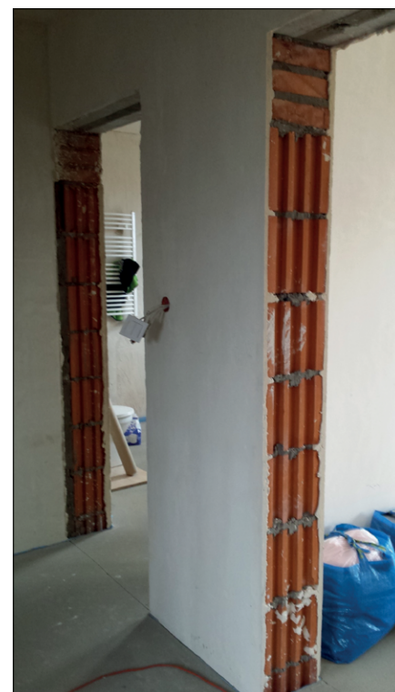
Fot. 7. Nieobrobione otwory drzwiowe. Aby zamontować drzwi, należy wykończyć na surowo ościeża otworów drzwiowych
