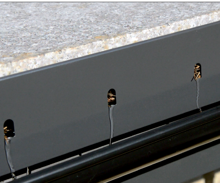
Fot. 4. Wypływ wody przez otwory odwodnienia awaryjnego profilu. Widoczne zanieczyszczenia, które zatkaly główne otwory odprowadzające wodę opadową (fot. Renoplast)
