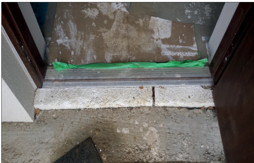
Fot. 6. Niezakończony montaż drzwi tarasowych z obu stron. Niewykończona i byle jak wykonana płyta betonowa tarasu ze spadkiem do budynku
