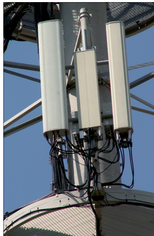
Fot. 3. Po lewej nowoczesna antena ze złączami 4,3–10, silniczki pochylające, tzw. RET, wewnątrz anteny. Środkowa i prawa antena: dostosowane do montażu silniczków RET na zewnątrz (dodatkowe wyposażenie), prawa bez silniczków
