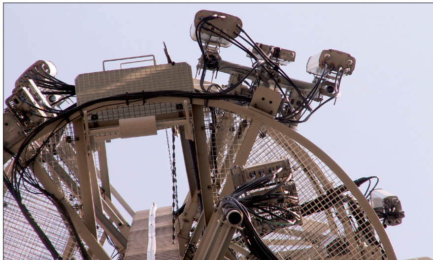
Fot. 4. Przykład rozkładu anten w stosunku do wejścia na wieżę
