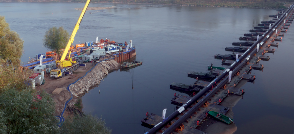
Tymczasowy układ przesyłowy
