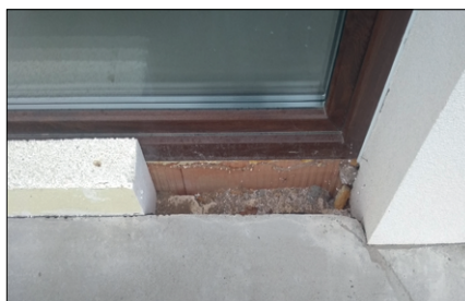
Fot. 2. Niezakończony montaż okna – izolacja termiczna wstawiona w kanał przy oknie, który jest zaśmiecony i pozbawiony izolacji przeciwwodnej
