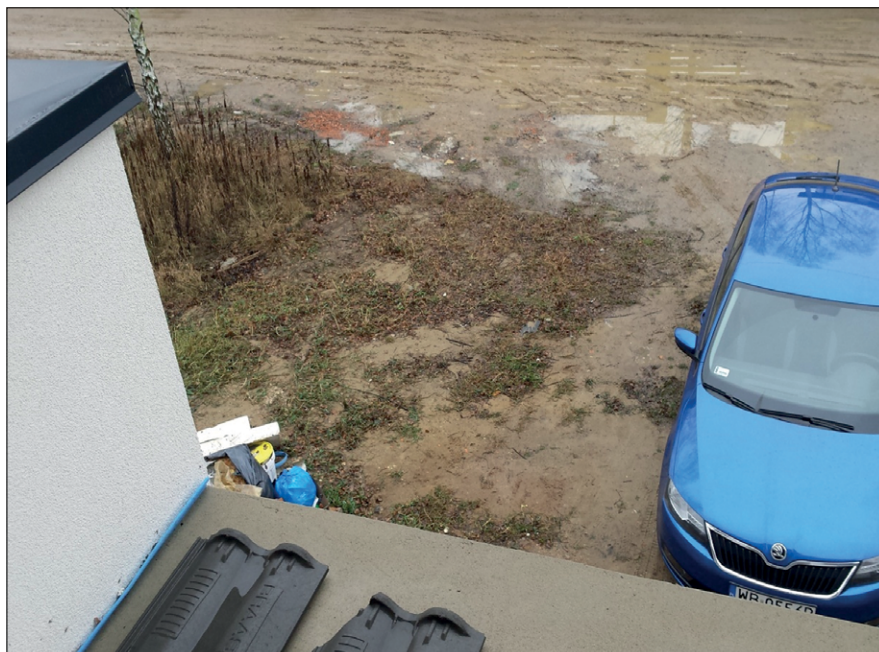
Fot. 4. Krawędź balkonu bez balustrady
