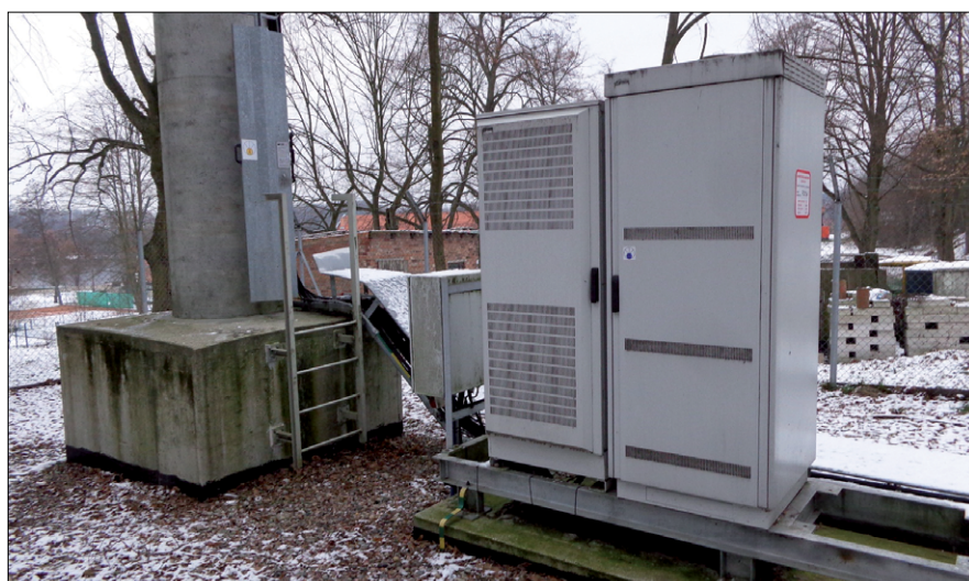
Fot. 5. Instalacja urządzeń typu outdoor
