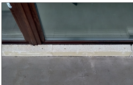
Fot. 1. Niezakończony montaż okna tarasowego – pozostawiona w stanie surowym nieciągnięta izolacja termiczna od zewnątrz. Taras niewykończony
