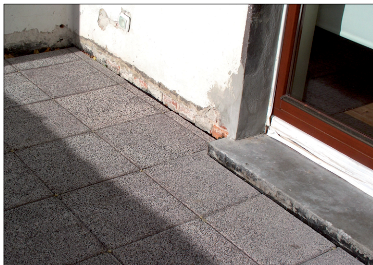
Fot. 6. Takie wykonanie „układu drenażowego” jest niedopuszczalne
