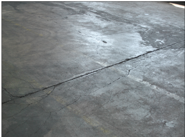
Fot. 2. Uszkodzona podłoga – przeciężona płyta podłogi
