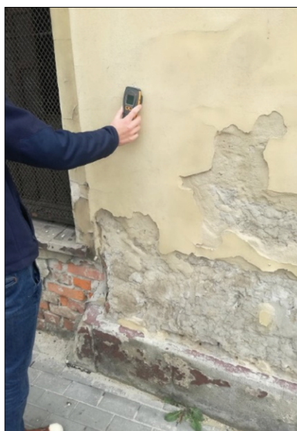
Fot. 4. Degradacja muru spowodowana podciąganiem kapilarnym
