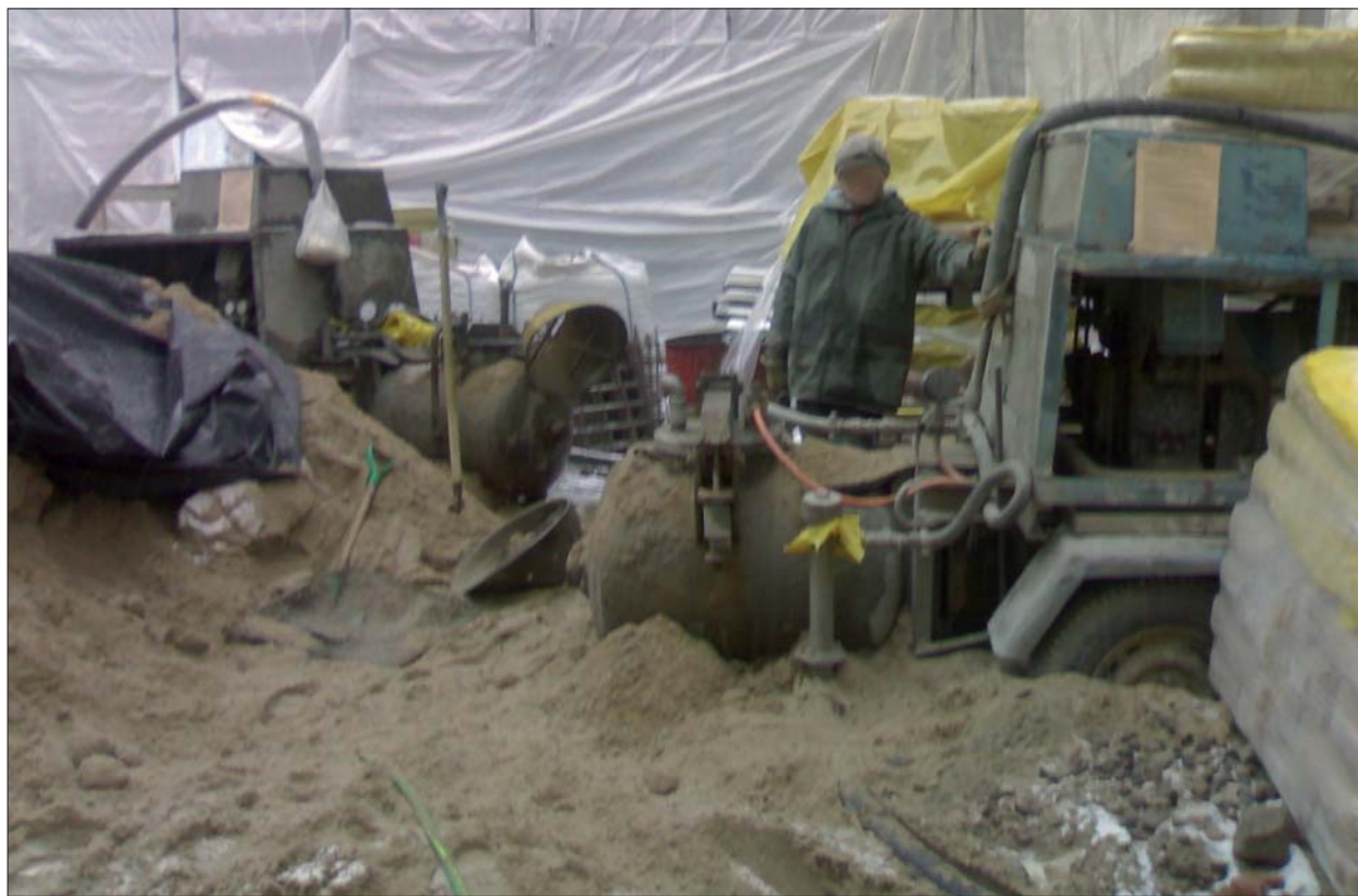
Fot. 1 | Przykład niedotrzymania technologii podczas wykonania podkładu podłogowego
