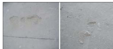
Fot. 3 | Występowanie niedopuszczalnych rak i zabrudzeń podkładu
