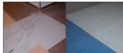
Fot. 4 | Przykłady samoistnie powstałych dylatacji
