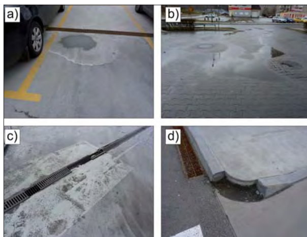
Fot. 5 | Przykłady nieprawidłowego wykonania oraz utrzymania elementów odwodnienia powierzchniowego parkingów:
