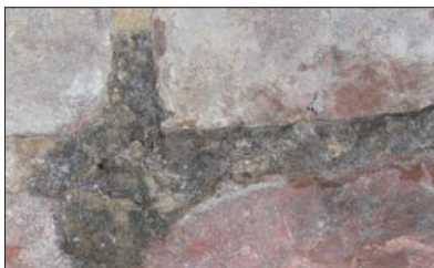
Fot. 5 | Grzyby pleśniowe rozwijające się w zawilgoconej piwnicy
