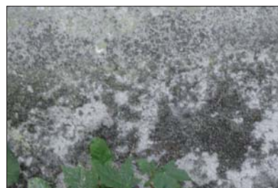
Fot. 4 | Grzyby pleśniowe rozwijające się na zewnątrz na zawilgoconym murze
