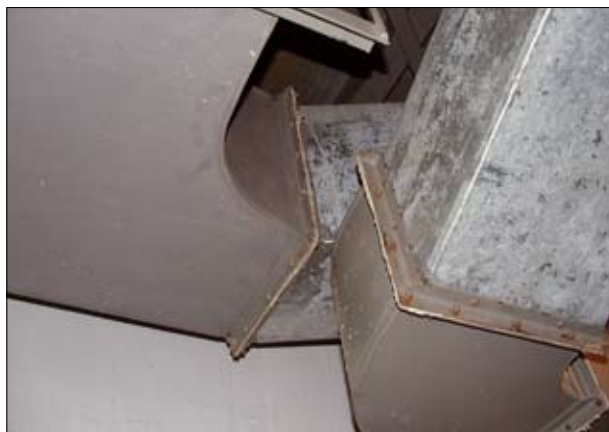
Fot. 1 | Uszczelnienia kanałów wentylacyjnych wewnątrz budynków, spotykane powszechnie w budynkach do 1996 r. w wentylacji mechanicznej. Występują także w budynkach typu Lipsk
