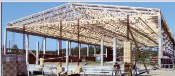
Fot. 1 | Hala z dachem z więzarów łączonych płytkami kolczastymi (Fot. Archiwum firmy Era ga)
