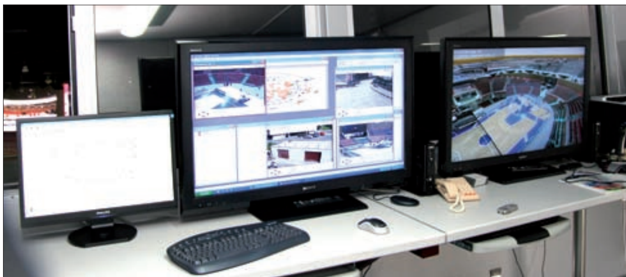
Fot. 3 | Stanowisko operatora monitoringu wizyjnego
