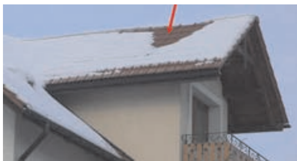
Rys. 10 | Poddasze, którego termogram od wewnątrz przedstawia rys. 9
