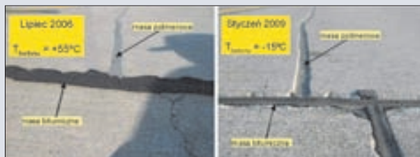
Rys. 7 | Porównanie pracy masy polimerowej i masy bitumicznej (konieczna była wymiana zdegradowanej masy bitumicznej) w ekstremalnych warunkach eksploatacji nawierzchni betonowej na lotnisku Kraków-Balice
