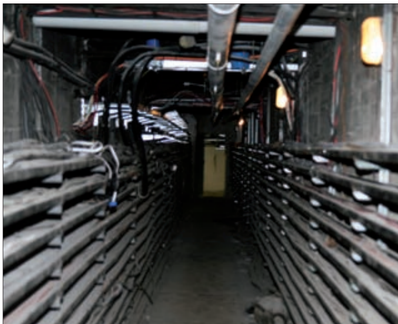
Fot. 2 | Półstała instalacja zraszaczowa w tunelu kablowym
