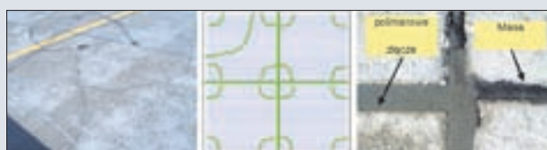
Rys. 5 | Widok uszkodzonej nawierzchni betonowej, schemat naprawy układu płyt przy użyciu polimerowego złącza podatnego oraz widok złącza polimerowego (bardzo dobry stan) i masy bitumicznej (silnie zdegradowanej - brak uszczelnienia) po czterech latach eksploatacji w warunkach lotniskowych (na drodze kołowania)
