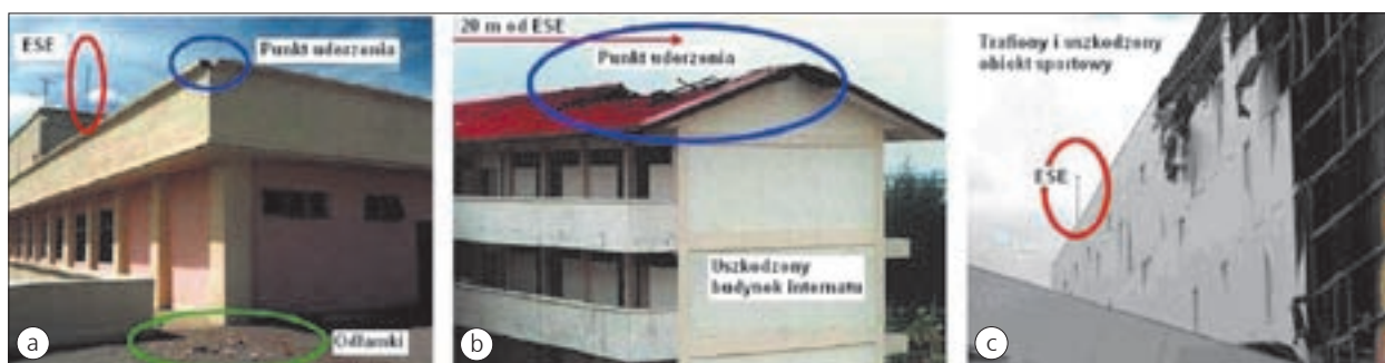
Fot. 1 | Przykłady uszkodzenia budynków chronionych zwodami aktywnymi: a) uszkodzenia mechaniczne budynku, b) pożar dachu w budynku internatu, c) pożar hali sportowej na przedmieściu Madrytu w 2005 r.
