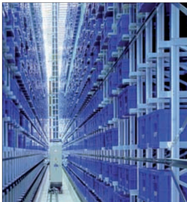
Fot. 3 | Pas jezdny podłogi z układnicą w magazynie wysokiego składowania
