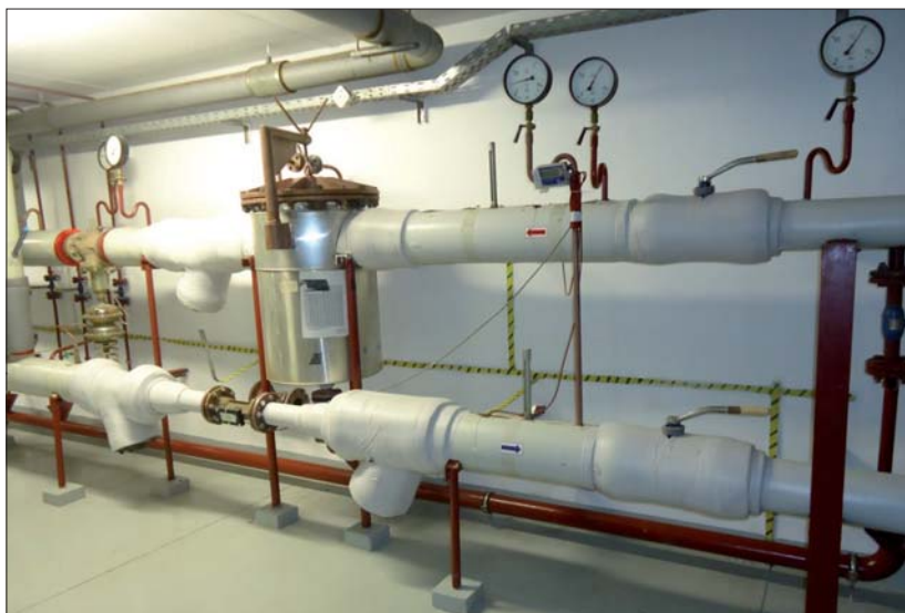
Fot. 1 Węzeł cieplny
