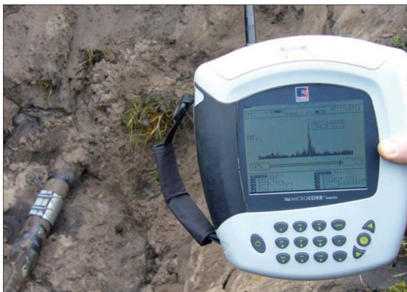
Fot. 8 Efekt lokalizacji wycieku na założonej opasce uzyskany za pomocą korelatora
