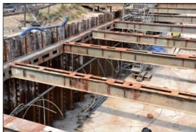
Fot. 10 | Wykop dojazdu do tunelu pod torami kolejowymi zabezpieczony ściankami szczelnymi kompozytowymi – przygotowanymi do zespolenia z żelbetową częścią szczelnej wanny
