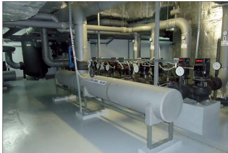
Fot. 5 Pompownia wody chłodniczej
