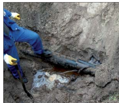
Fot. 6 | Awaria rurociągu PEHD
