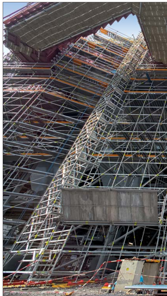
Fot. 1 | Elektrownia w Hamm
