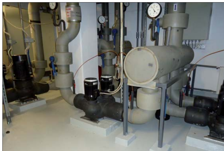
Fot. 6 Szczegóły zabezpieczenia instalacji w pompowni wody chłodniczej
