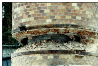
Fot. 1, 2 | Nieprawidłowa rozbiórka
