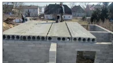
Fot. 2 | Płyty żerańskie pozwalają na szybki montaż stropu, ale wymagają zastosowania ciężkiego sprzętu
